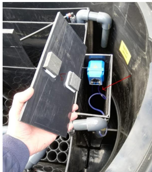
Bilden visar den indbyggda tanken för fosforfällningsmedel inklusive inbyggd doseringspump
